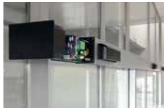
Più efficiente gestione dell'installazione e della manutenzione.
